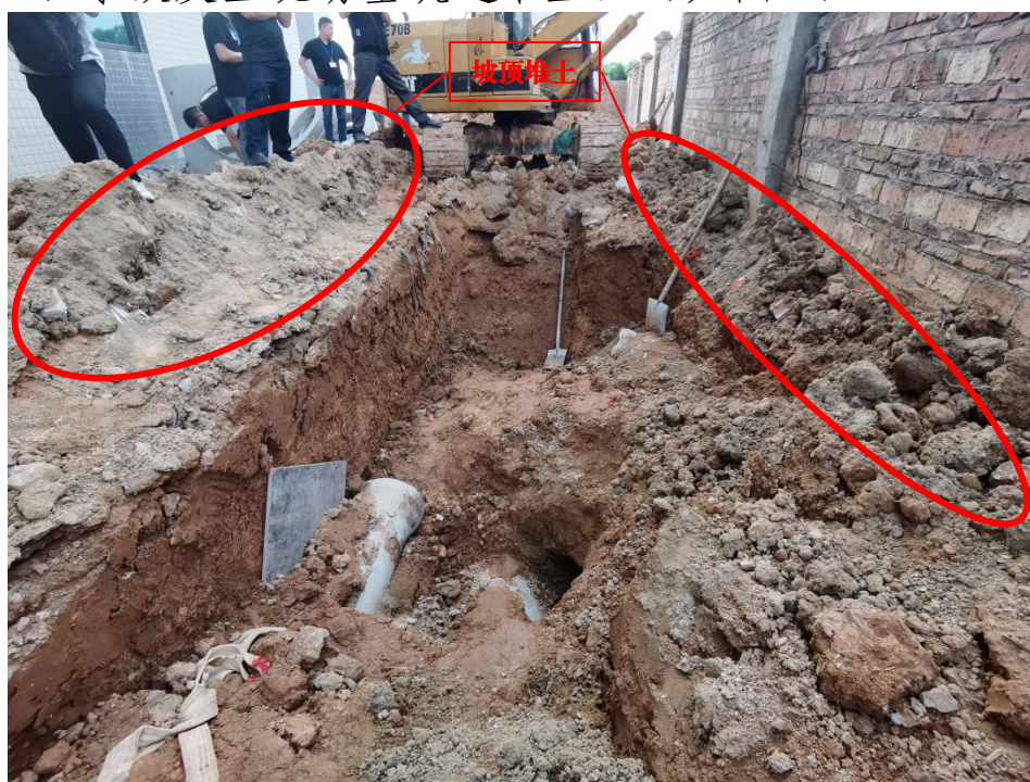
图 7 事故发生现场基坑边堆土
