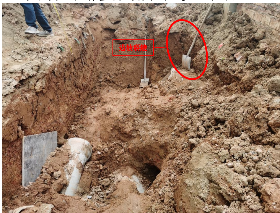
图 8 事故发生现场基坑边存在裂缝
